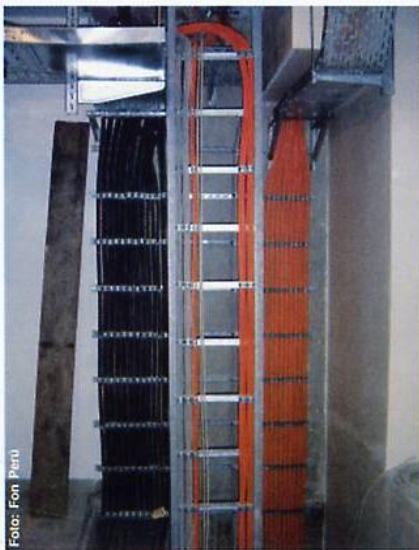
Mantener la alta protección al acceso de distribución de cables, los servidores y componentes de redes como switches y routers
